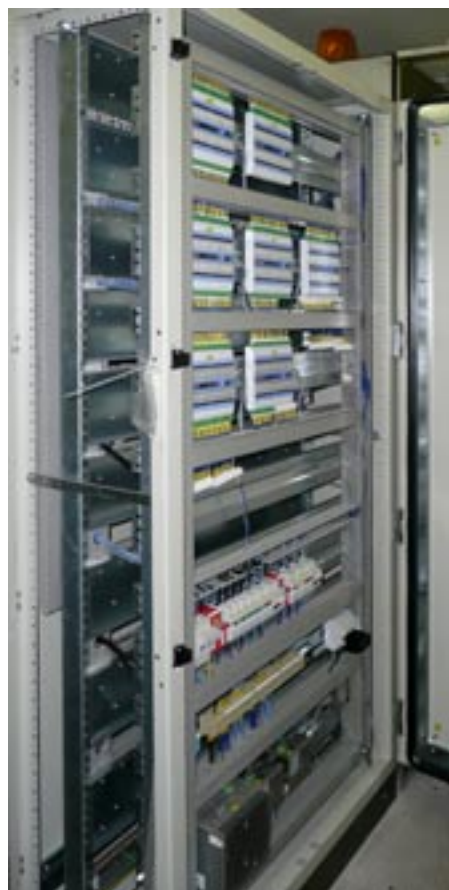
Do rozvaděče je instalováno 10 jednotek DataLab IO4
